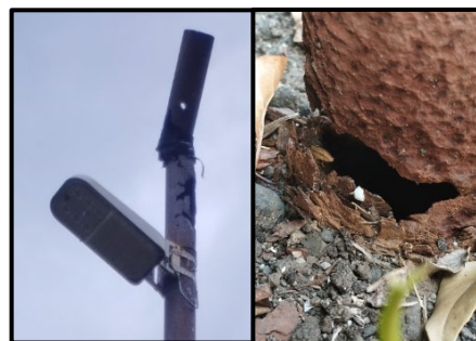
ポールの劣化事例
