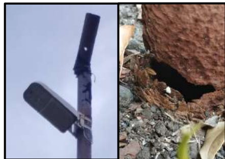
ポールの劣化事例
