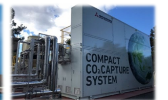
焼却工場のCO 2 回収 (CCUの実証試験)
